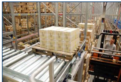
Palettenförderanlage: Die Förderleistung beträgt ca. 200 Paletten / h
